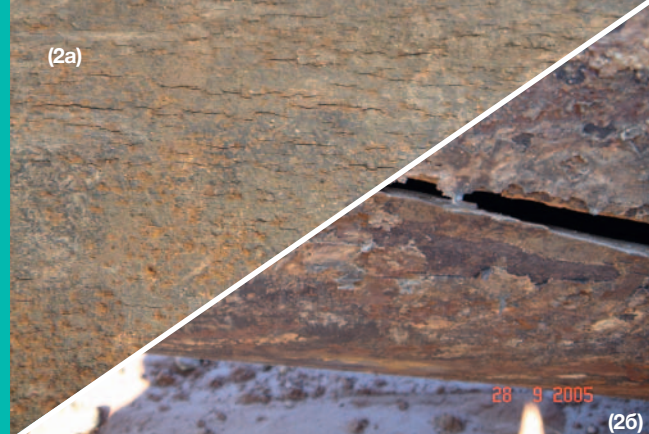
Рис. 2. Дефекты КРН, выявленные МТМ до разрушения в ходе ресурсных испытаний (2а) и результат их разрушения по хрупкому механизму (2б)
